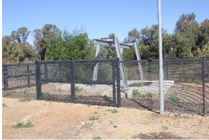
Rosenburg sewer PS
