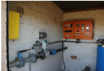
Kalbaskraal Booster PS bulk water meter
